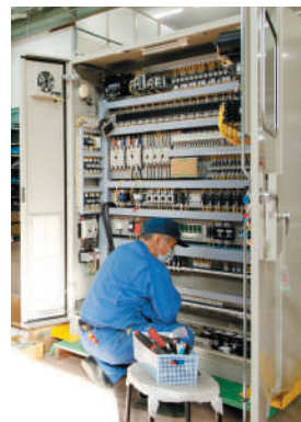
高品質の制御盤システムを製造
